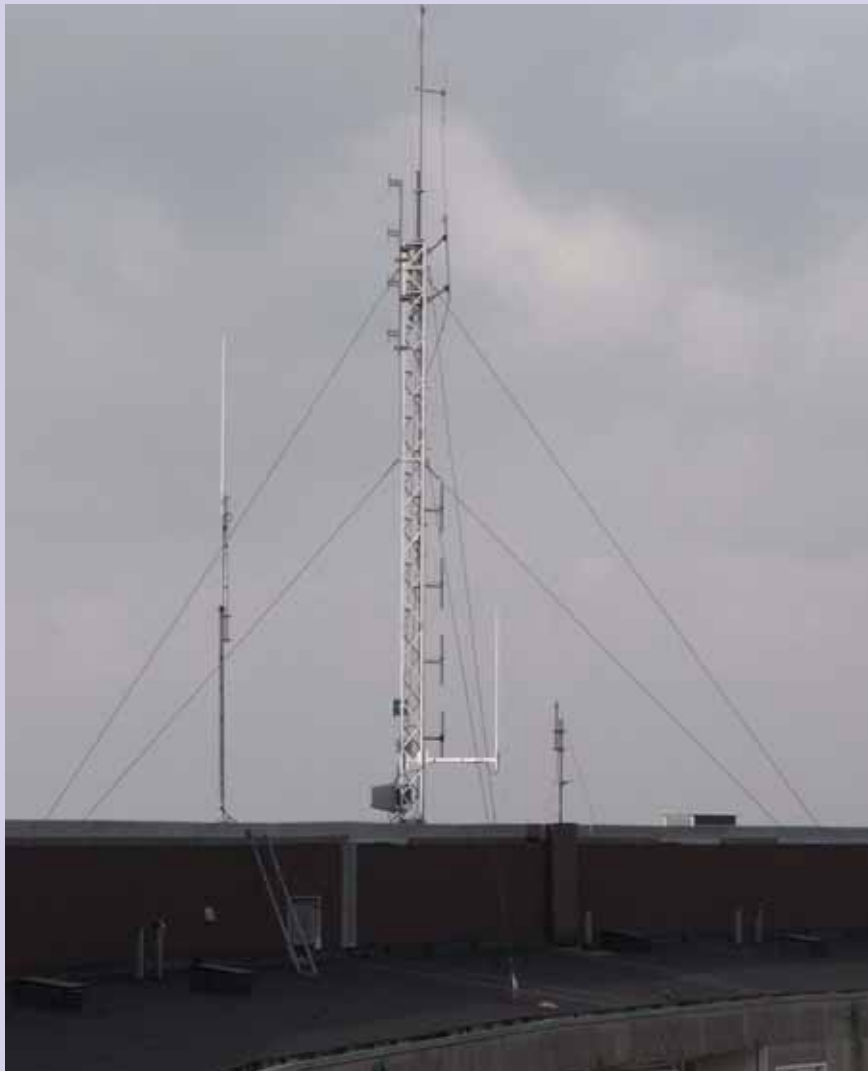
GSA:s antenner på Guldheden
